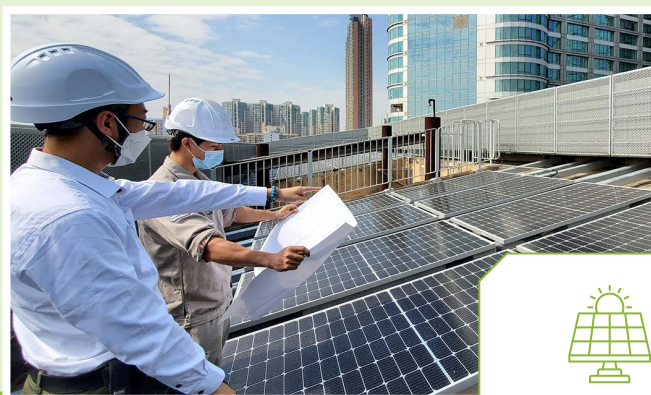
● 頂樓的太陽能光伏板
